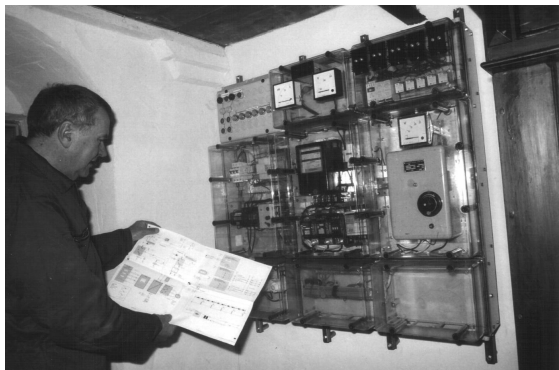
Abb.3 Überprüfung des elektrischen Teils vor der Inbetriebnahme
